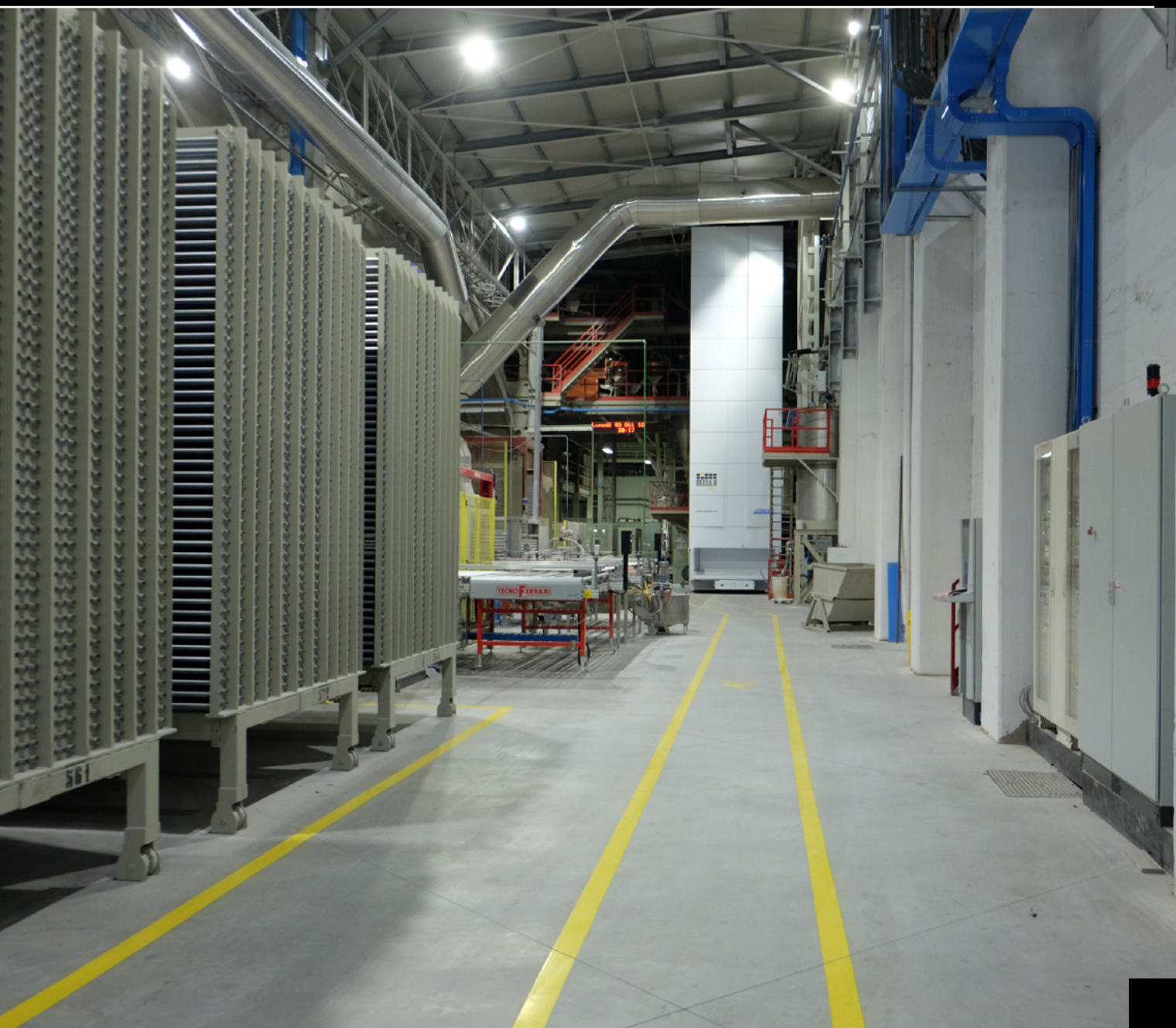
RADIANT 6M1 ICU
